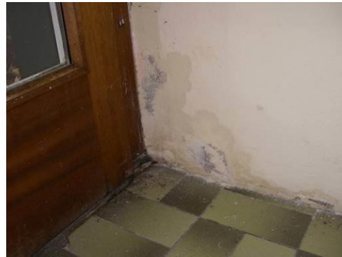
Folge: Feuchtigkeit im Inneren des Gebäudes
